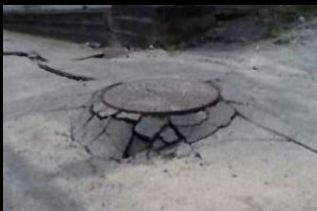
マンホールの浮上りによる段差
