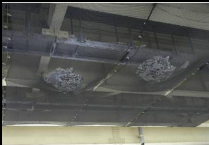
床版コンクリートのはく落
