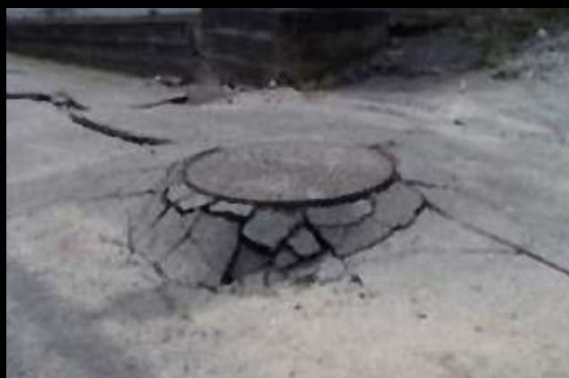
マンホールの浮上りによる段差
