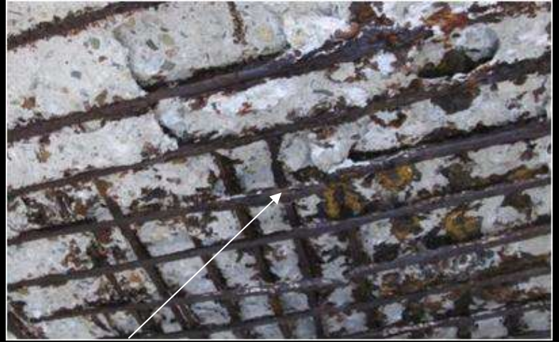
床版鉄筋の破断・腐食及びひび割れの進行
