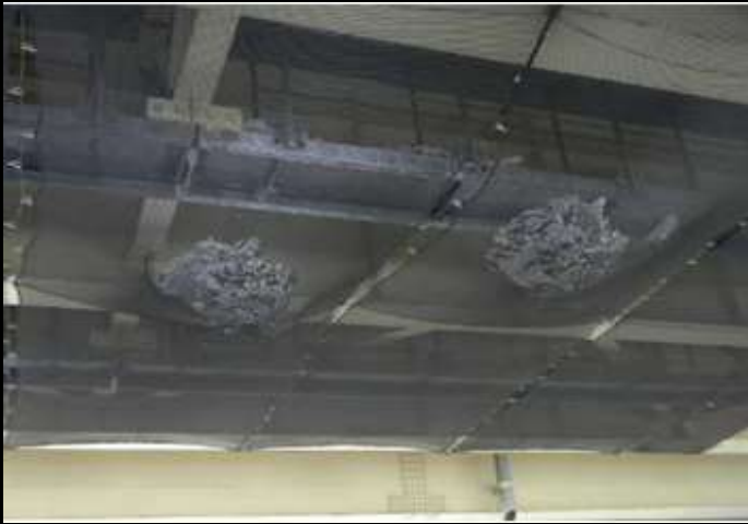
床版コンクリートのはく落
